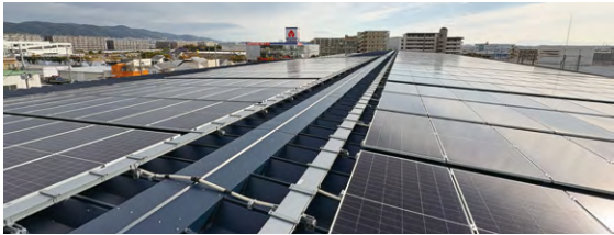
伊丹営業センター太陽光パネル
