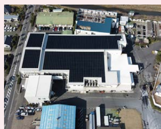
阿久根工場太陽光パネル
