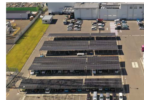
青木食品の太陽光パネル
